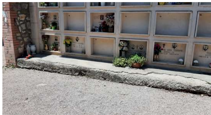
Uno dei tanti marciapiedi usurati.
