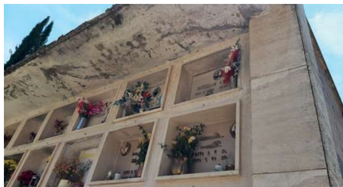
Una delle tante pensiline fatiscenti. A dicembre, sei mesi dopo la nostra segnalazione sono stati allocati 10.500€ per riparare 6 pensiline e 2 marciapiedi.
